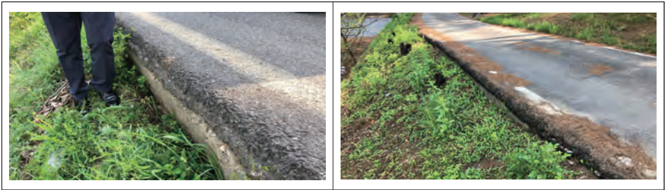
그림 2 | 세굴로 인한 도로붕괴위험 부여군 사례
