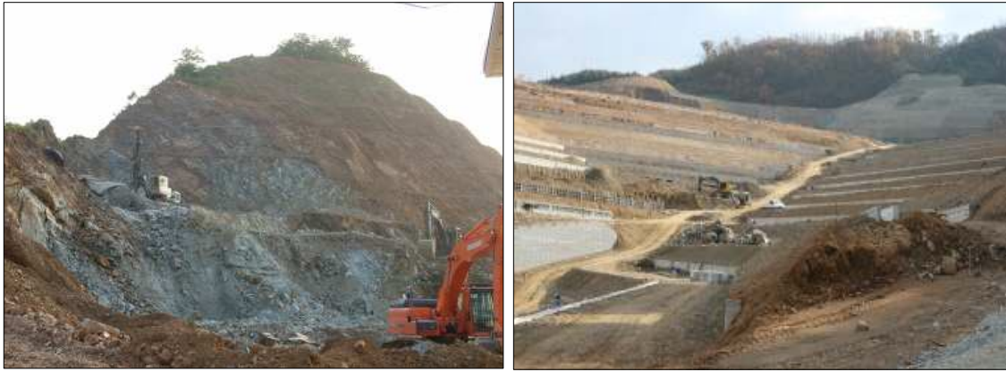
【그림 3】 산지의 평탄지 개발에 의한 자연경관 훼손 및 재해발생 사례
