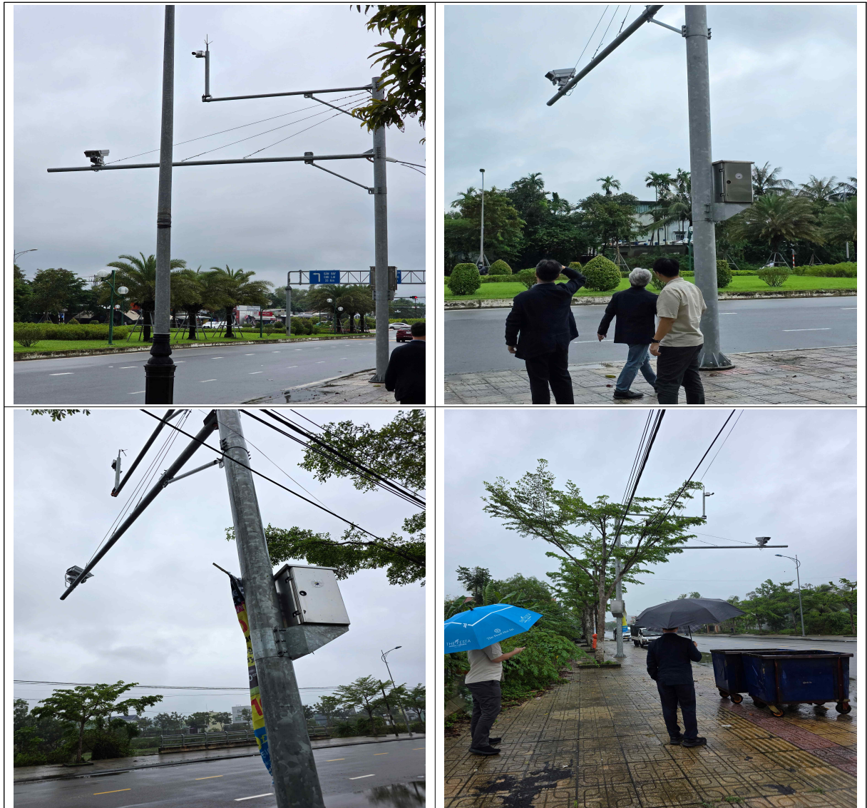
땀끼시 스마트시티 실증서비스 현장점검(과속단속CCTV)
