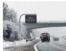
VMS (Variable Message Sign)
